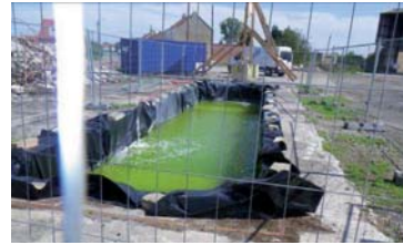
Août : Unité de traitement sur site des eaux de nettoyage
